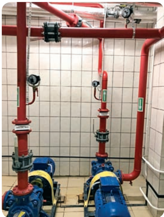
ИНДИВИДУАЛЬНЫЙ ТЕПЛОВОЙ ПУНКТ
